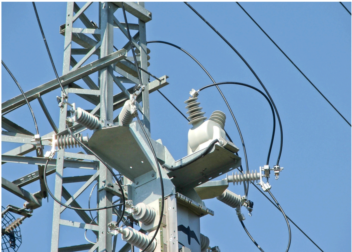
12. kép: a készülékek burkolt áramvezetőinek csatlakozó szerelvényein legtöbbször nincs burkolat
