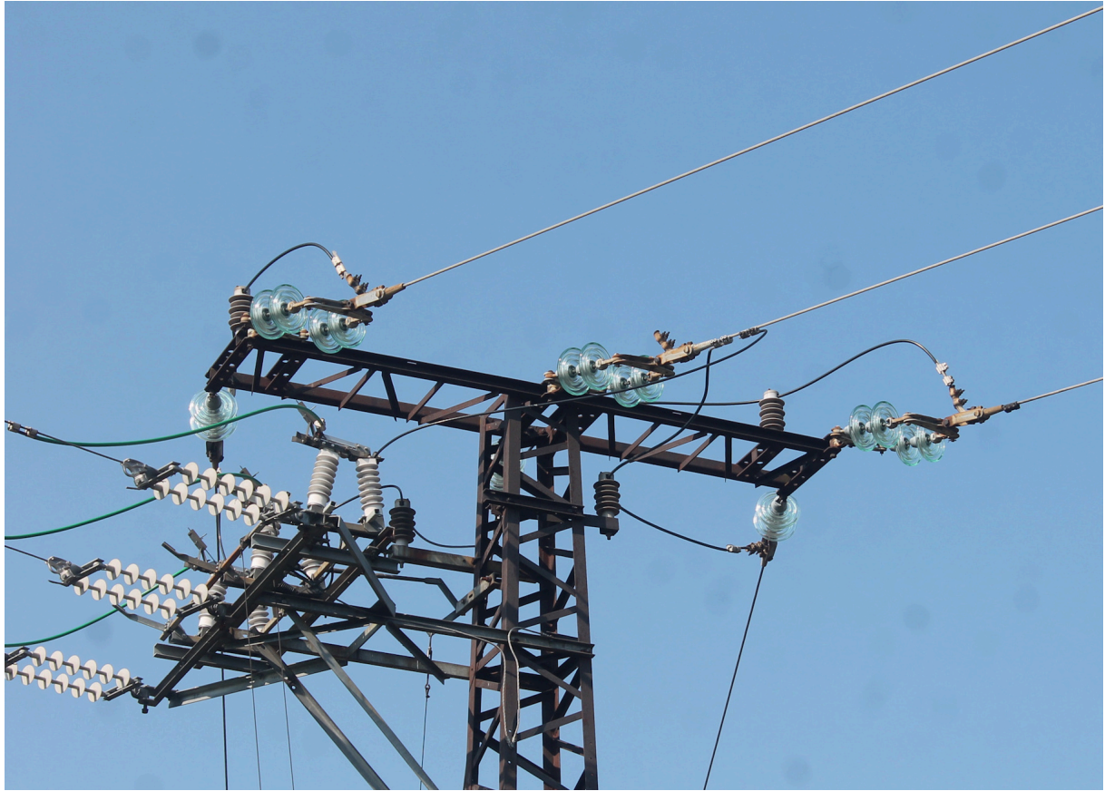
3. kép: burkolt vezetős áramkötések hibásan kialakított, felfelé irányuló, csupasz csatlakozásokkal
