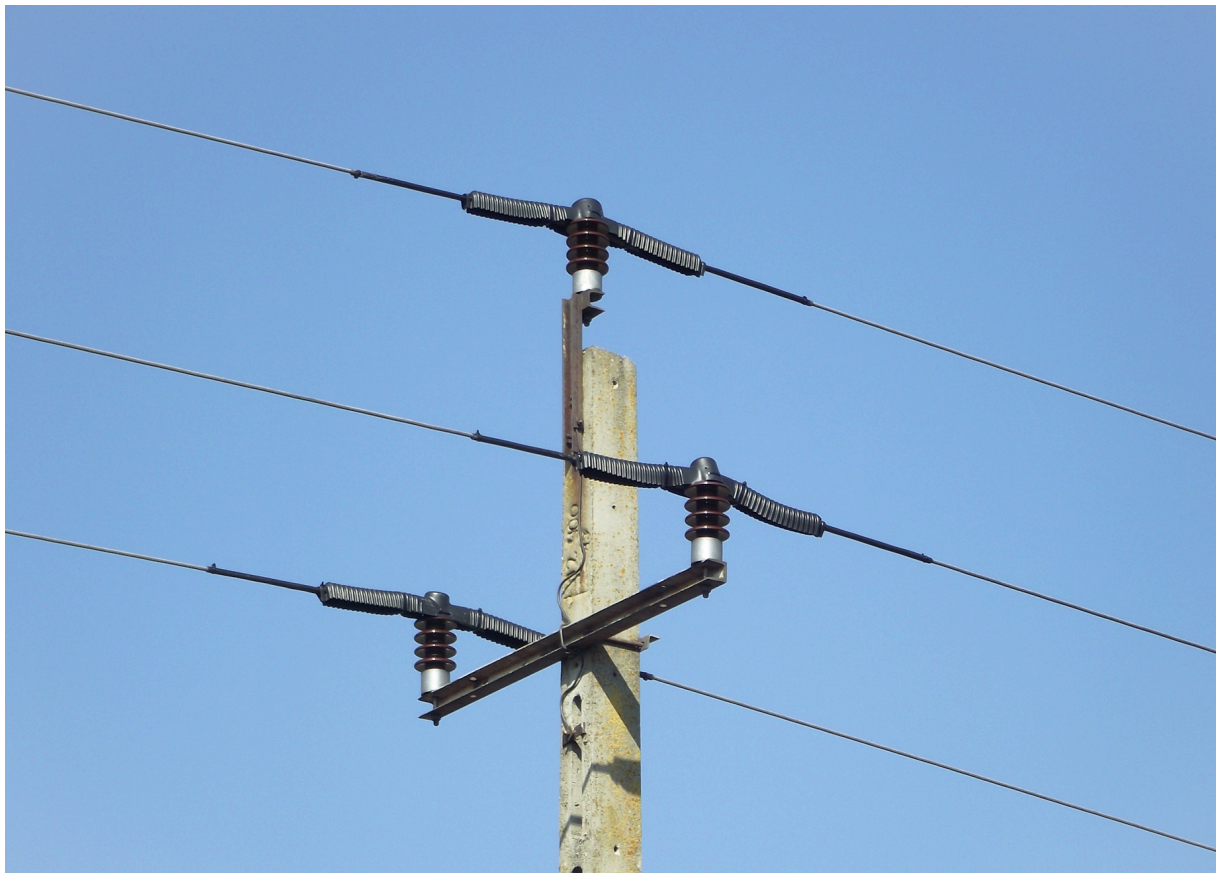
14. kép: egy előírás szerint kiegészített tartóoszlop, jó általános állapotú madárvédő burkolatokkal
