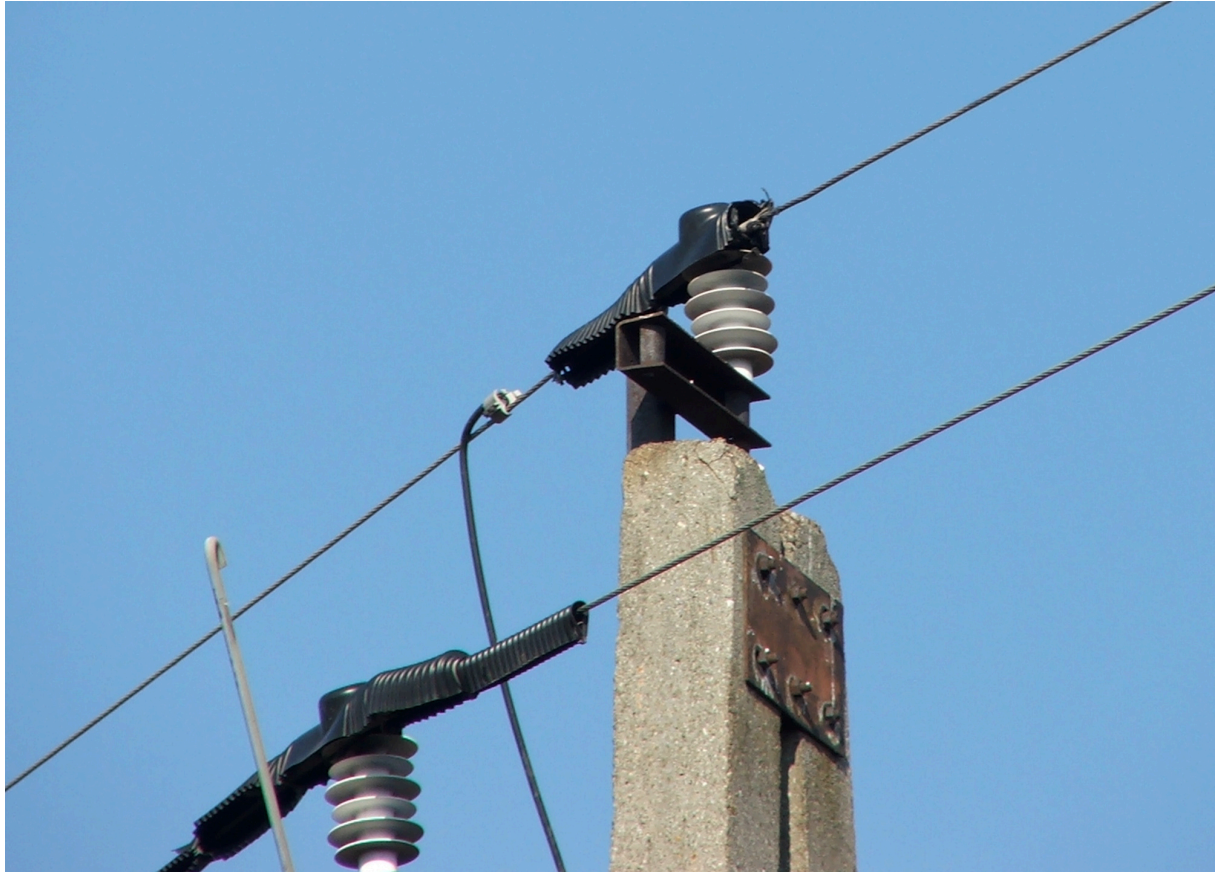
7. kép: villámlás túlfeszültségének átívelése károsította a hiányosan szerelt madárvédő burkolatot
