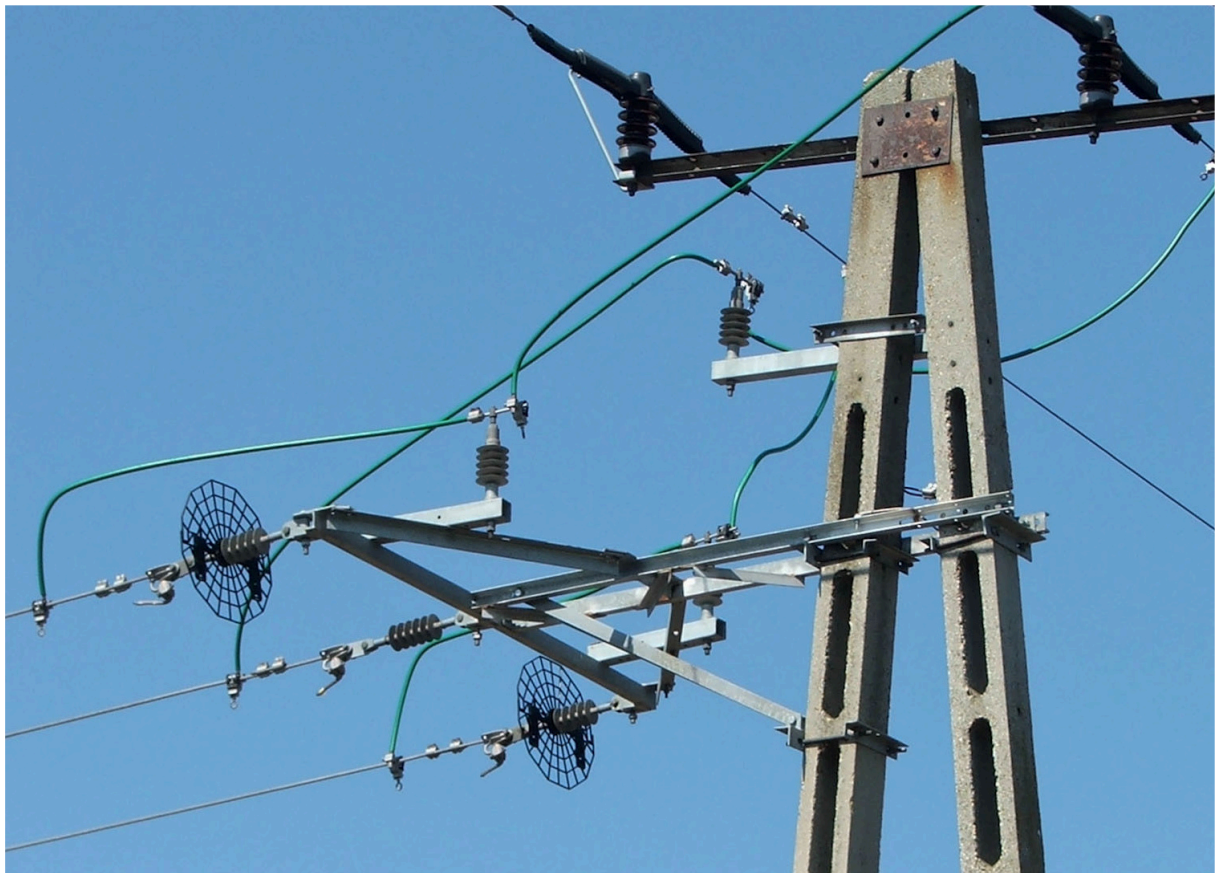
4. kép: csapos FAM szigetelők szerelvényrészsel felfelé pozícionált, veszélyesen hibás elhelyezése
