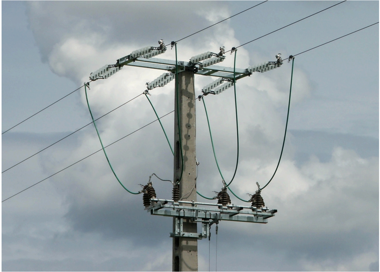
13. kép: az oszloptörzsre szerelt kapcsoló és a 780 mm-es szigetelőlánc növeli a madarak biztonságát
