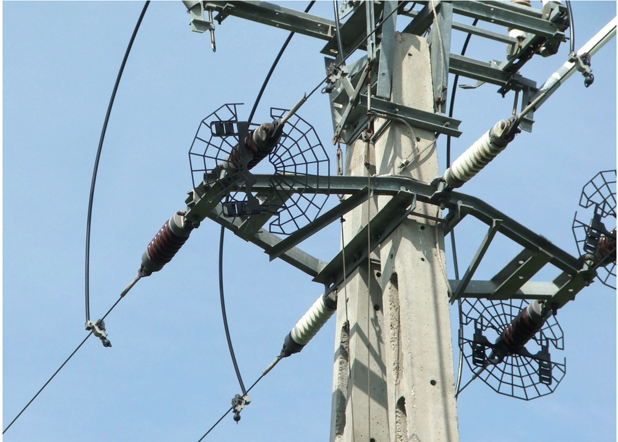
11. kép: a hibásan rögzített (rögíthető?) madárszárnyterelők egy része már leesett a rúdszigetelőről
