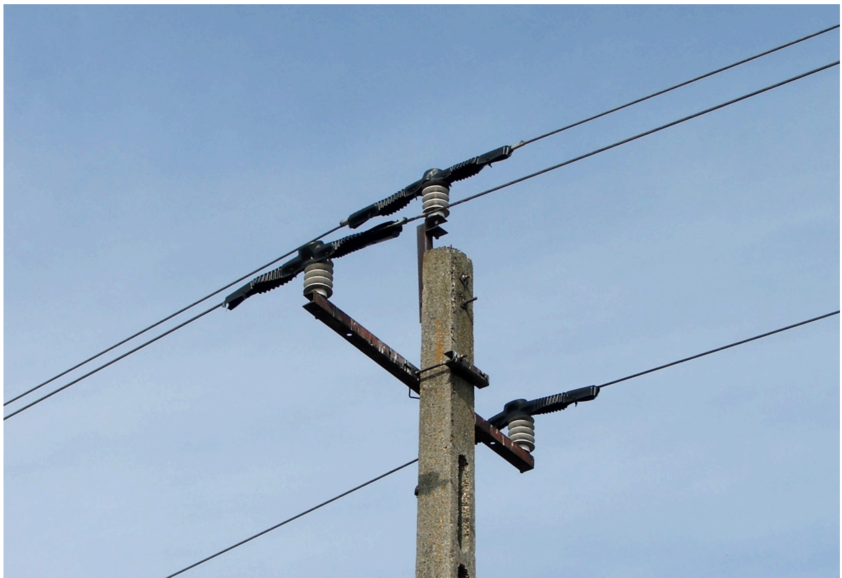
2. kép: burkolathosszabbító nélküli madárvédő burkolatok egy hiányosan szerelt tartóoszlopon
