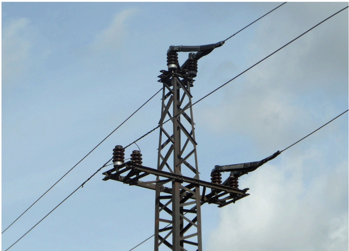
6. kép: az üzemzavar elhárítása során eltávolított burkolat az áramütés esélyét jelentősen megnöveli
