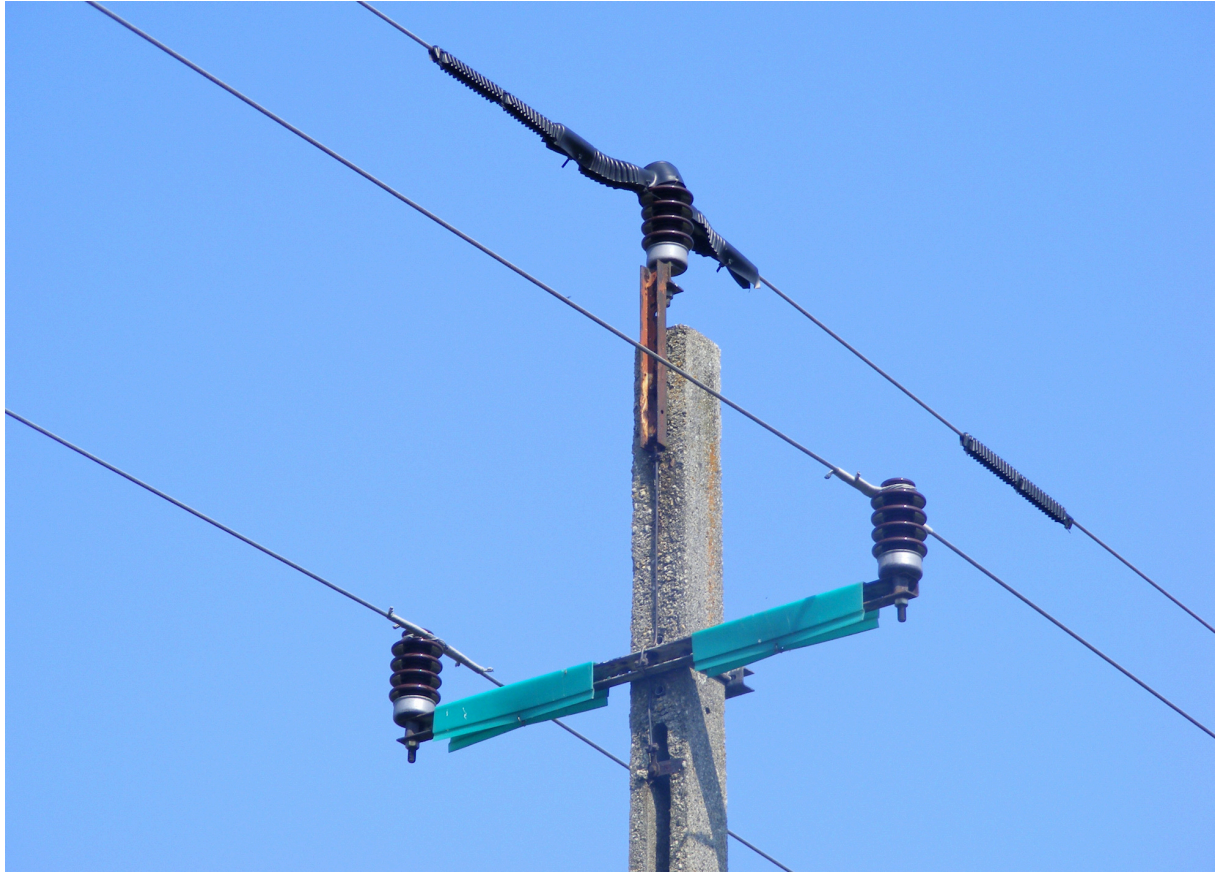
5. kép: szigetelő papucssal és madárvédő burkolattal kiegészített hibás, hiányos védelmű oszlop
