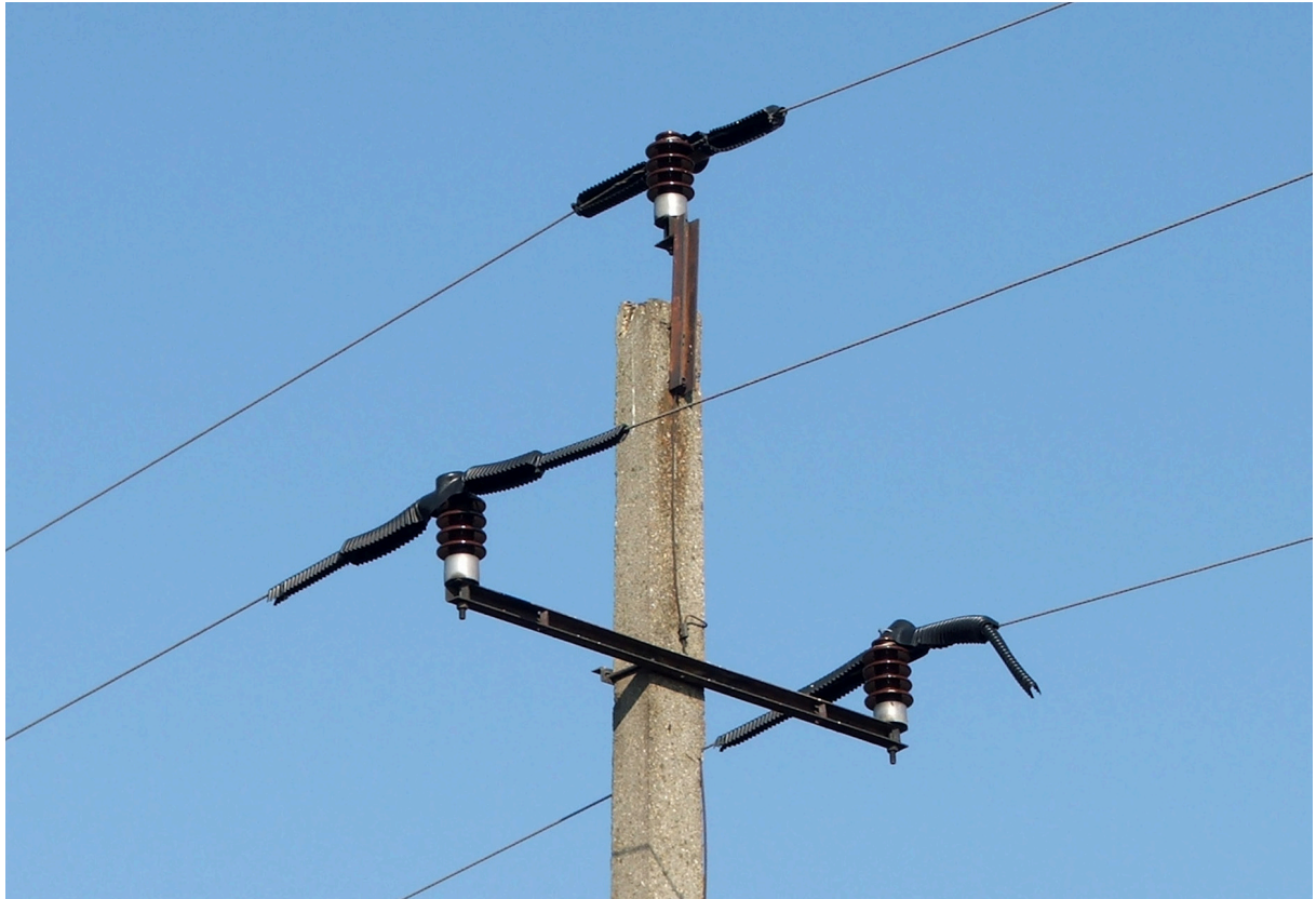
1. kép: madárvédő burkolattal kiegészített, többszörös hibával, hiányossággal szerelt tartóoszlop
