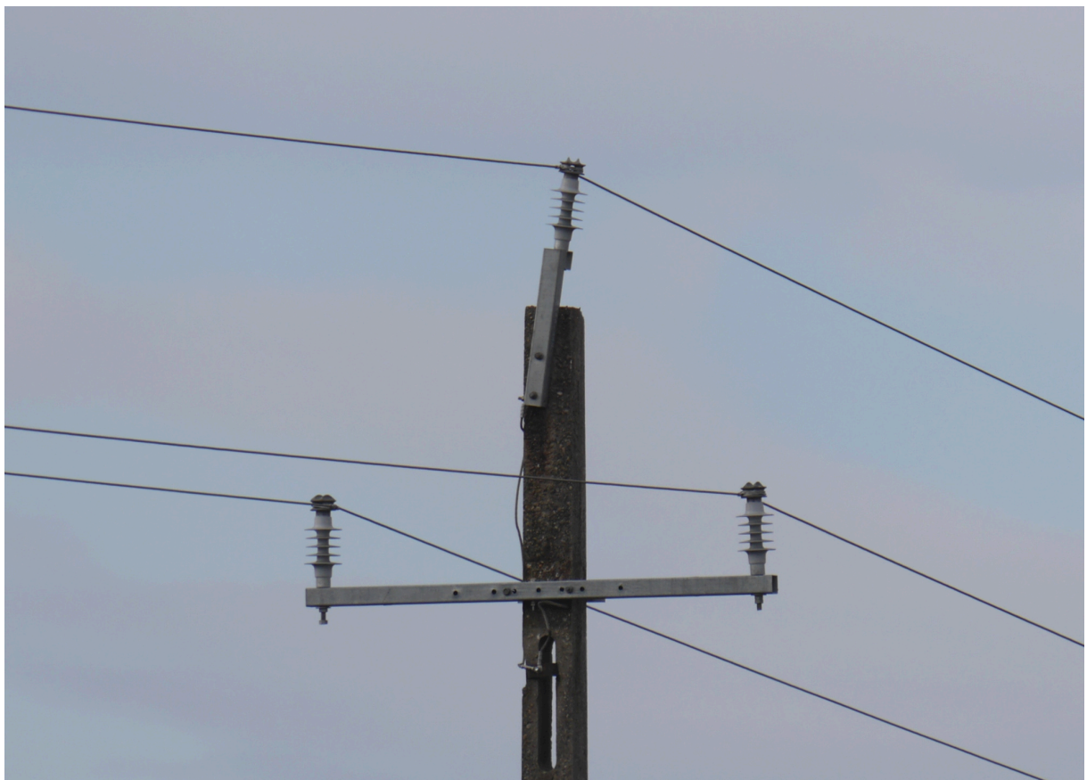
10. kép: a 9. képen ábrázolt oszlop állószigetelős fejszerkezettel, madárvédelem nélkül (2017. 10. hó)
